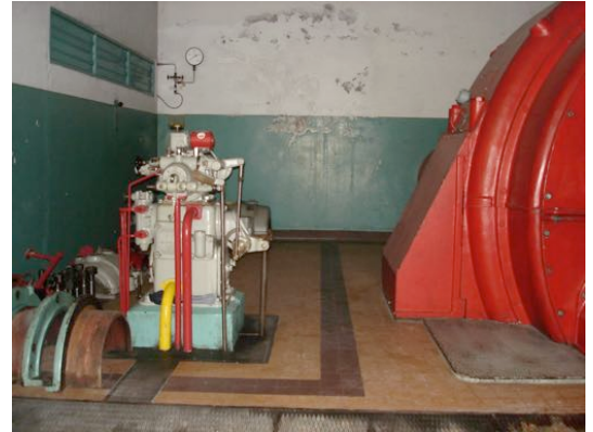
A gauche, le régulateur de l'ancien groupe
